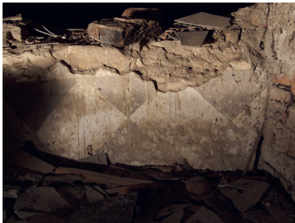
Obr. 29: Budkovce, Kaštieľ – nález pôvodne exteriérového pásu iluzívneho listového sgrafita pod korunou muriva (dnes v podkroví).
