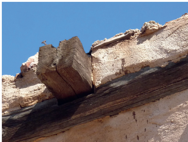
Obr. 10: Hrad Krásna Hôrka po požiarí v marci 2012 – kampovaný spoj zvyšku krovu z 1. štvrtiny 19. storočia (pomurnica – vážný trám).
